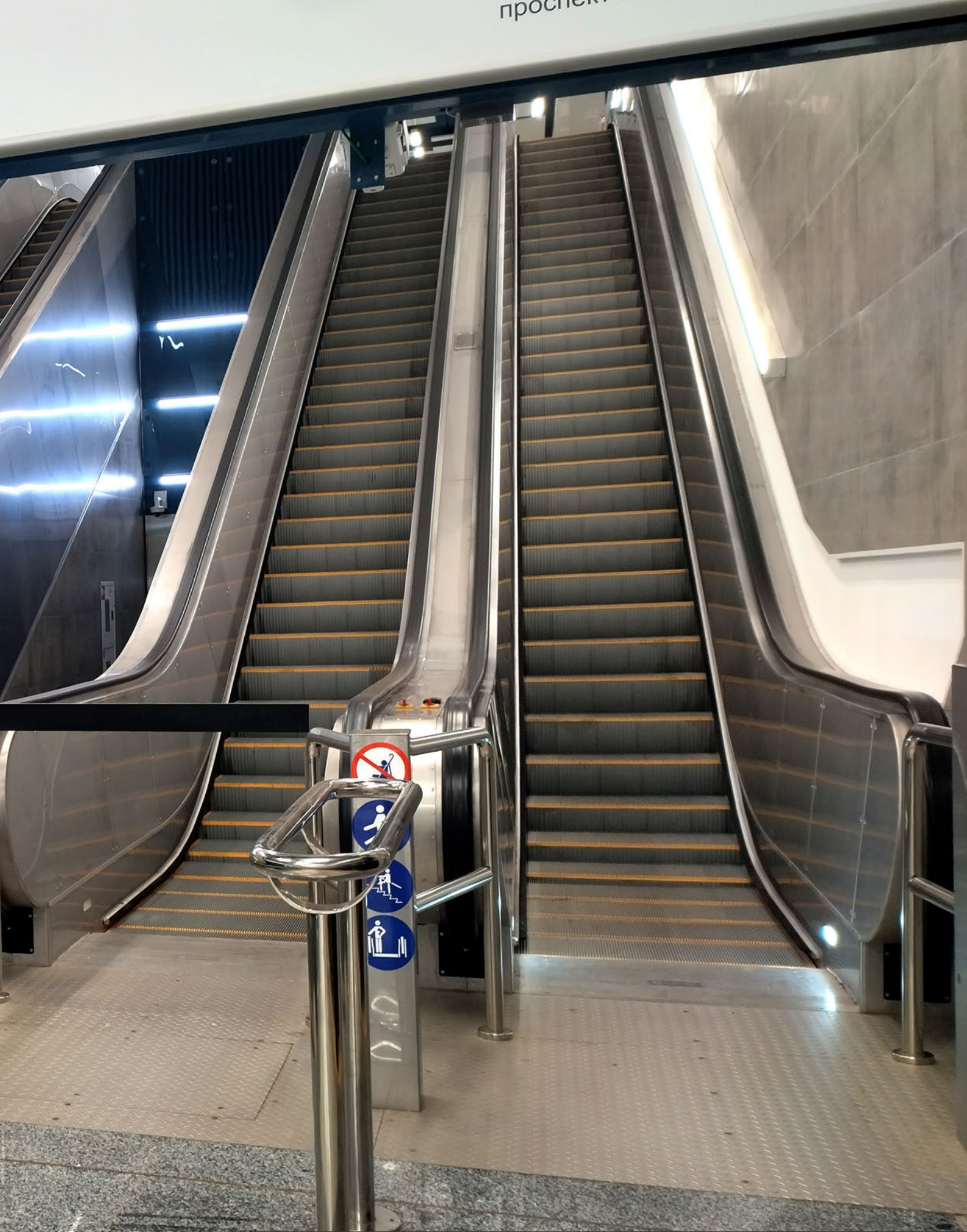
ЭСКАЛАТОРЫ НА СТАНЦИИ МЕТРО «АЭРОДРОМНАЯ», Г. МИНСК
