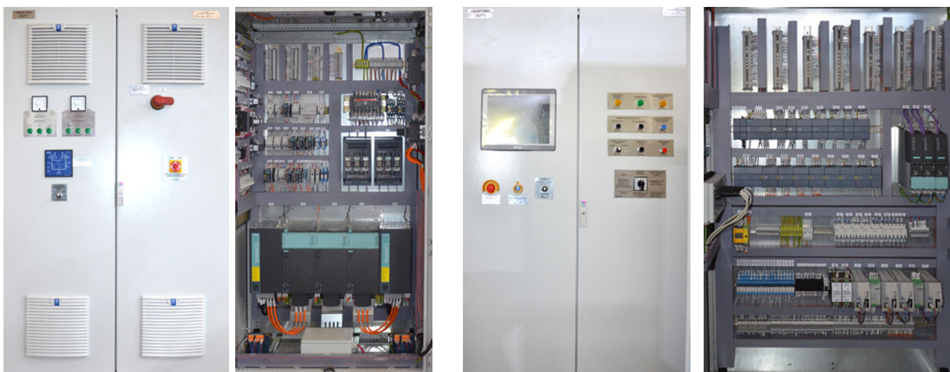
Шкафы микропроцессорного контроллера управления конвейером пассажирским
